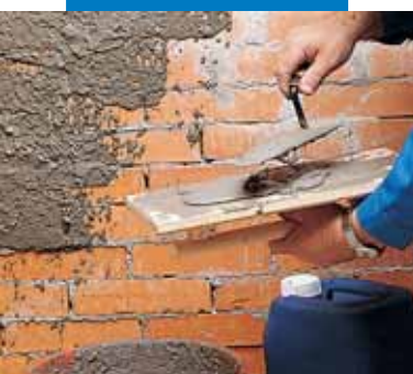
Rinzaffo additivato con Planicrete
